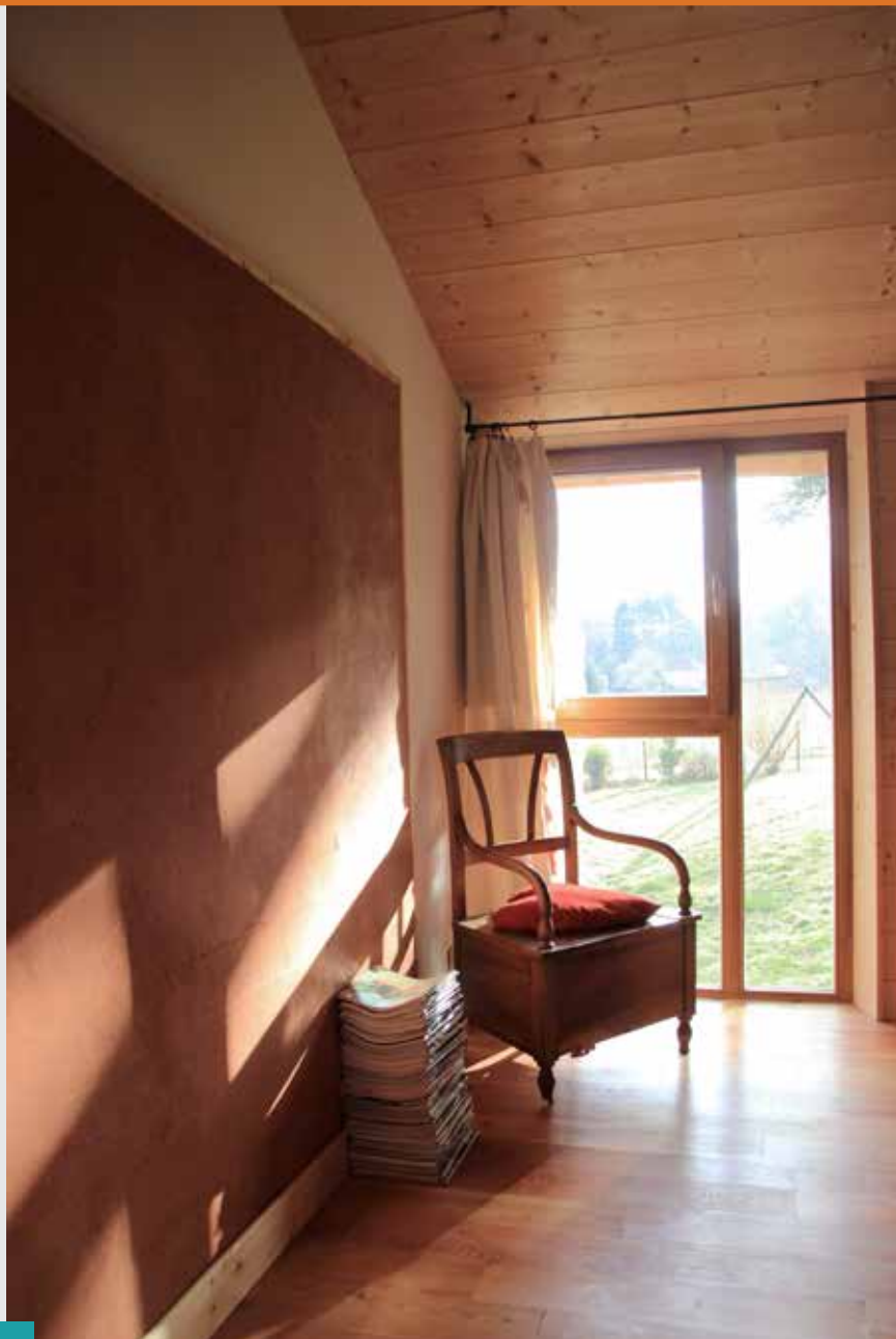
Les enduits terre recouvrent les tubes de PER, seuls les murs de refends sont ainsi équipés de serpentins.
